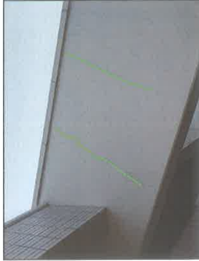
外部梁のひび割れ
