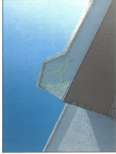
軒立ち上がり部分のひび割れ
